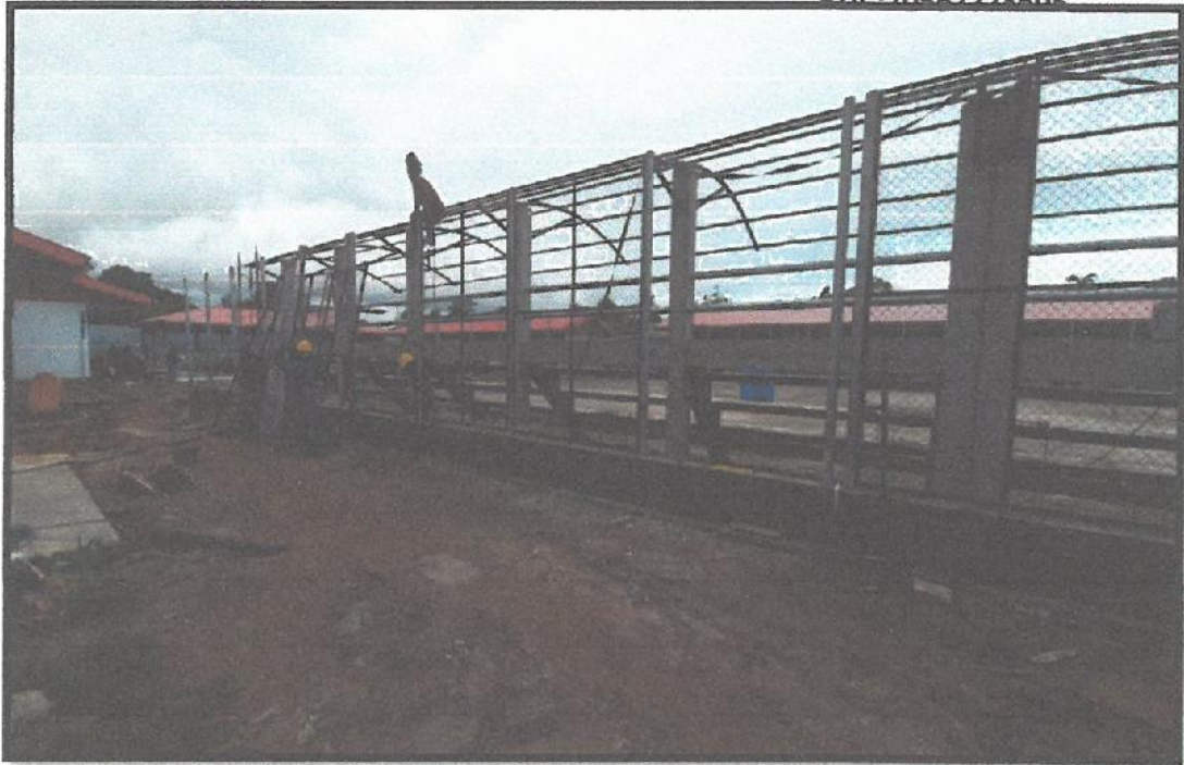
IMAGEN Nº 03: SE APRECIA TRABAJOS DE CERCO METALICO EN LA LOSA DEPORTIVA DE LA I.E
