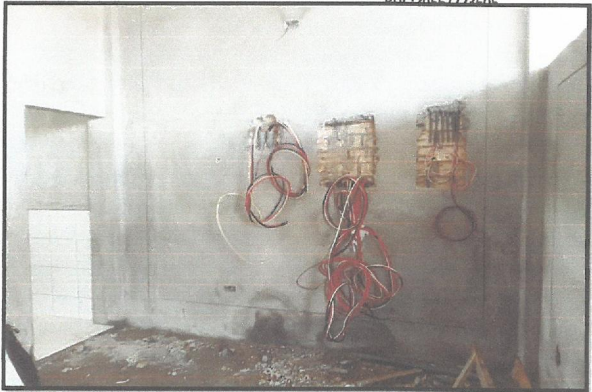
IMAGEN Nº 11: EN LA SIGUIENTE IMAGEN SE PUEDE OBSERVAR LOS PUNTOS DE SALIDA, LISTOS PARA PODER REALIZAR LA INSTALACION DEL TABLERO
